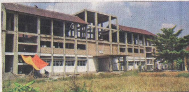
DIDUGA SALAH SPEK: Proyek pembangunan gedung SMP Negeri 42 Semarang yang mangkrak.
