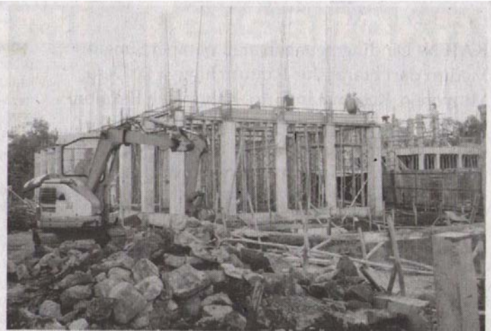
DIPERCEPAT : Pekerja sedang melaksanakan pembangunan gedung SMPN 3 Purbalingga di Kelurahan Purbalingga Lor. Pembangunan dengan alokasi anggaran Rp 23 Miliar lebih tersebut diminta dipercepat. ■ Foto : Joko Santoso-Tj
