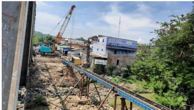
Pekerja melaksanakan proyek pembangunan Jembatan Besi Sampangan, Kota Semarang, Selasa (24/11/2020). (TRIBUN JATENG / EKA YULIANTI FAJLIN)
